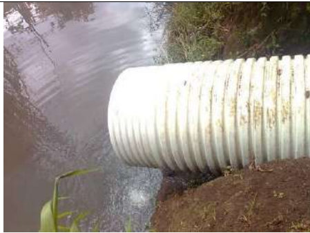
Fotografía 7-4.49. Urb. El Futuro. Descarga de aguas hacia el río
