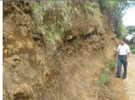
Fotografía 7-4.26. Esperanza 1. Taludes que provocan derrumbes.
