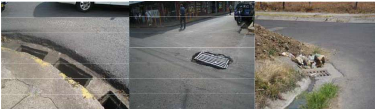
Problemas de infraestructura pluvial
