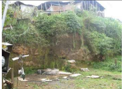
Fotografía 7-4.28. Esperanza 1. Viviendas ubicadas en zona de riesgo.
