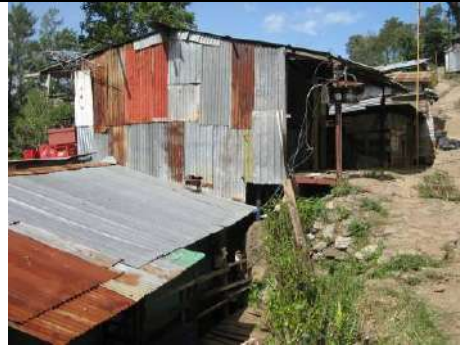
Fotografía 7-4.54. Caro Quintero. Viviendas en malestado y en lugares inadecuados.
