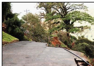
Carretera afectada por el terremoto.
